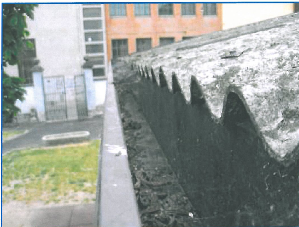
Foto 3 - Canale di gronda e stalattiti
