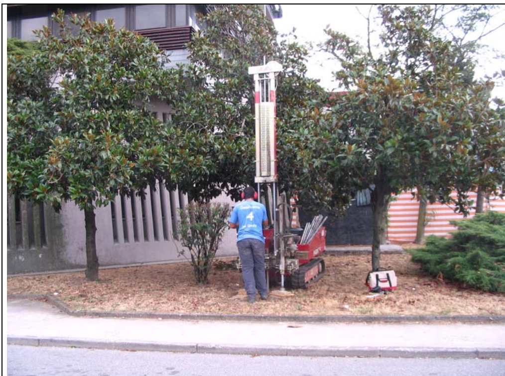
Foto 8 – Prova penetrometrica dinamica P2.
