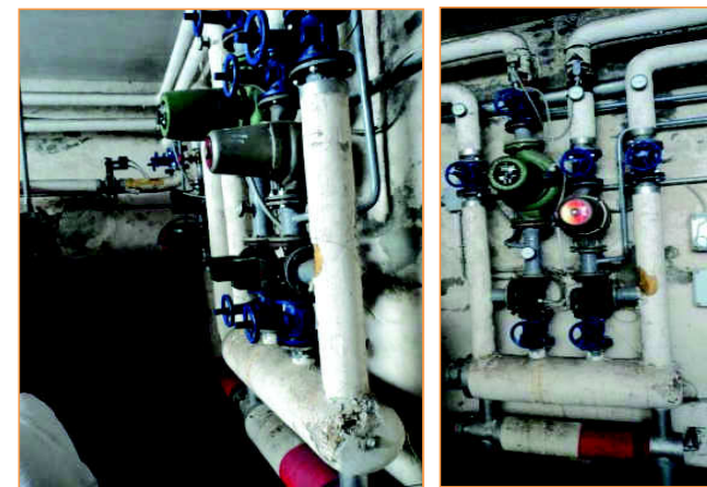
pompe di distribuzione
