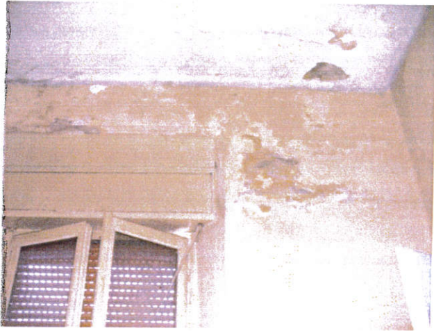
immagine soffitto ed infiltrazione d'acqua
