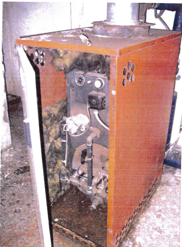
generatore in centrale termica
