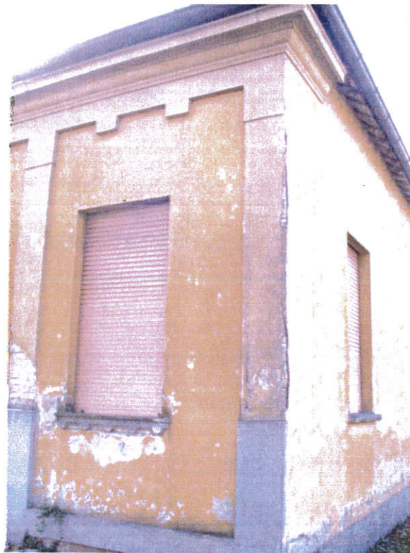
particolare danneggiamento strato d'intonaco
