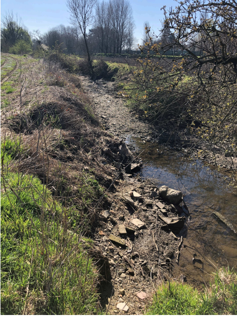
2A – Alveo Roggia Squintana con evidenti segni di cedimenti spondali e riporti antropici a danno del regolare deflusso idrico. Manutenzione assente.
