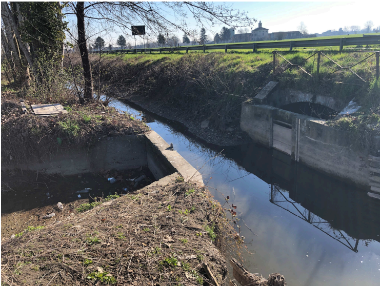
1B – Innesto di roggia Rio con Roggia Squintana. L'intubamento è dato dalla continuazione di roggia Rio al di sotto della S.S.235. Sono evidenti depositi di rifiuti a monte del sifone di sottopasso della Roggia Rio sotto roggia Squintana.
