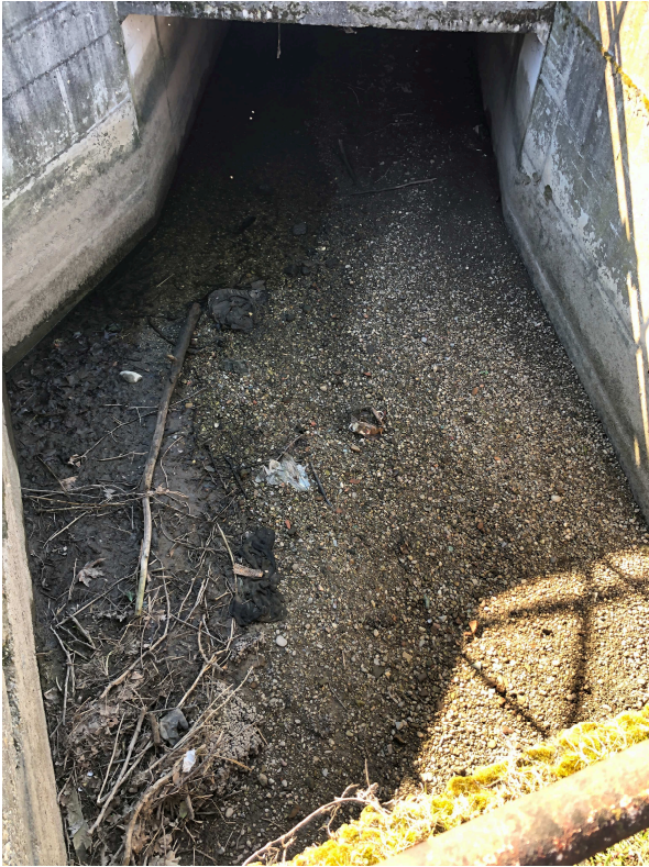
1E - Sottopasso di roggia Squintana al di sotto della rotatoria ad est di C.na Spolverera. Sono evidenti i detriti e la sedimentazione incontrollata che ostacola il deflusso idrico. Manutenzione assente.
