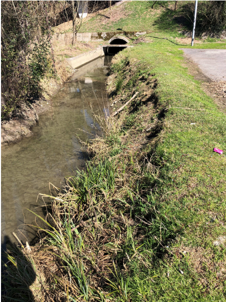
4D – Roggia scaricatore del Pulignano localmente estubata, con sponde cedevoli e intubamento sotto Viale Dalmazia parzialmente occluso da passerella pedonale.
