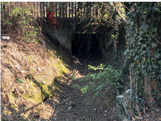
5D – Intubamento del ramo secondario Roggia Cassinetta-Boccalera con sottopasso della ferrovia Milano - Piacenza. Sono possibili rigurgiti e allagamenti dei locali interrati delle palazzine ad ovest di Via Giuseppe Piermarini.
