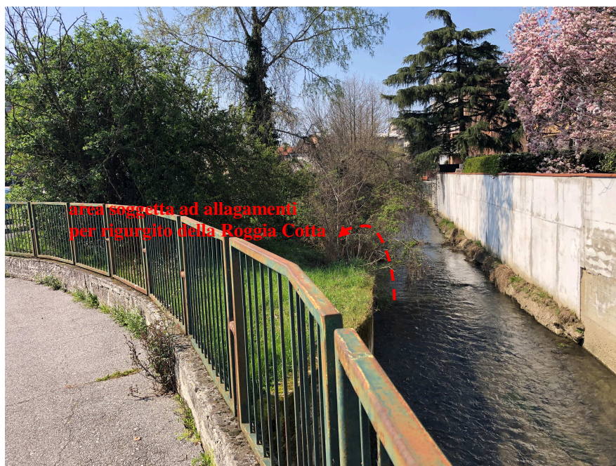
5A – Zona critica in corrispondenza dell'intubamento di Via Bruno Buozzi di Roggia Bertonica.
