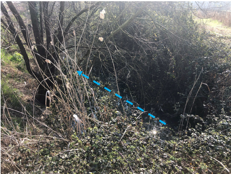
6D – Alveo Roggia Turana quasi completamente invaso da vegetazione arbustiva spondale a nord est della caserma dei Vigili del Fuoco.
