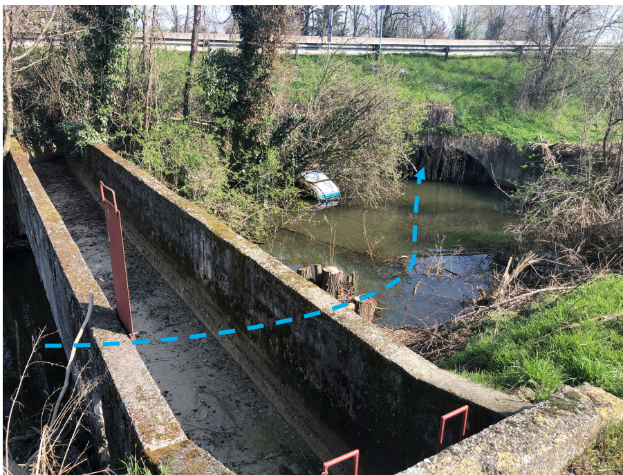
5F – Sottopasso di Roggia Turana sotto S.S.9 - Emilia. Sono presenti rifiuti e arbusti che impediscono il buon deflusso idrico.
