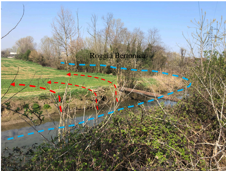
5E – Zona ribassata a nord di C.na Favalla. L'area è soggetta a possibili sovralluvionamenti di Roggia Bertonica caratterizzata, in questo tratto, da evidenti cedimenti spondali.
